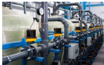
Impianti trattamento acque
