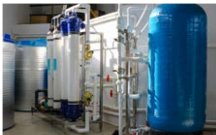
Sistemi di filtrazione dell'acqua
